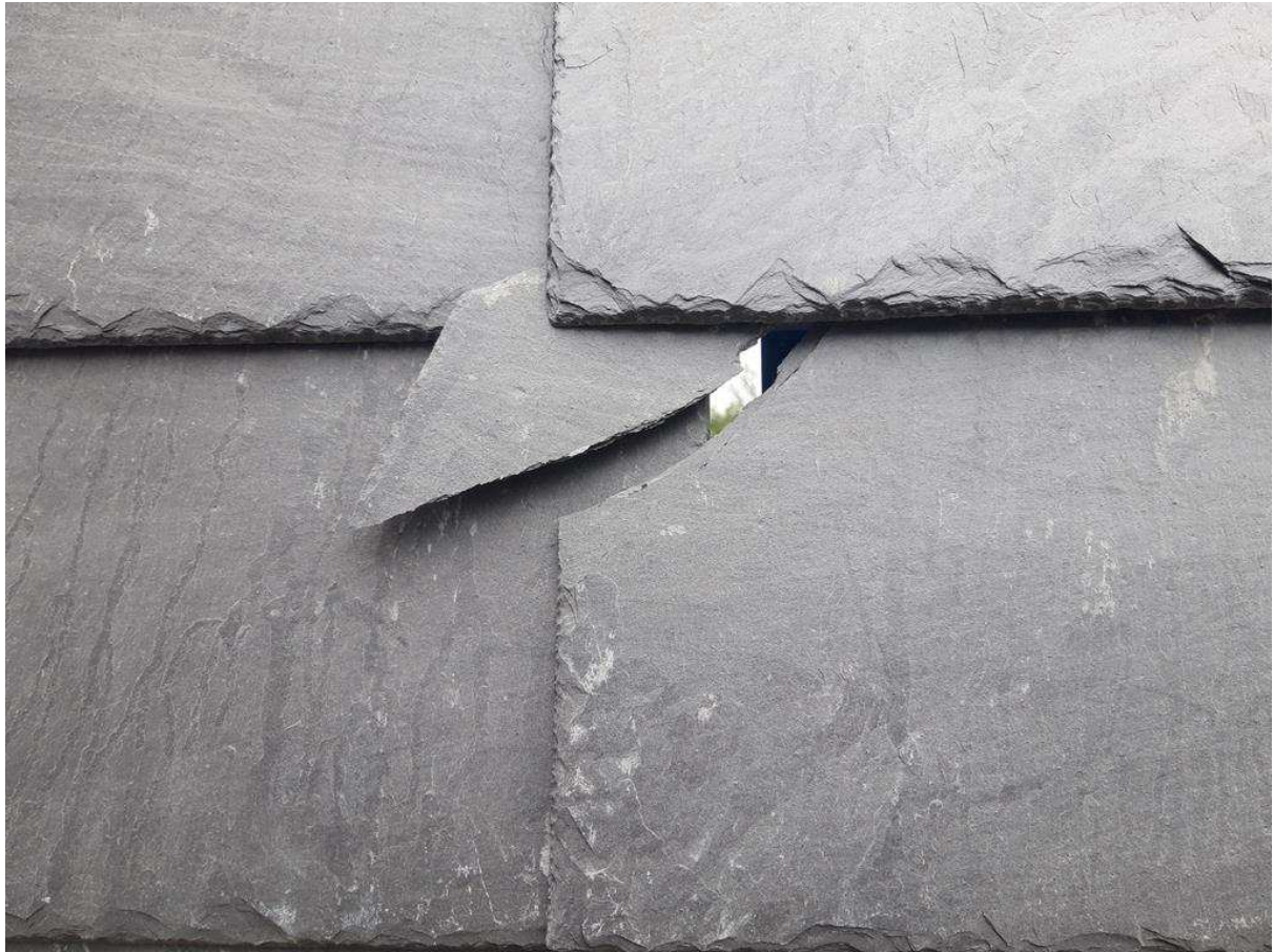
Caída de trozo de placa en el minuto 2:06
